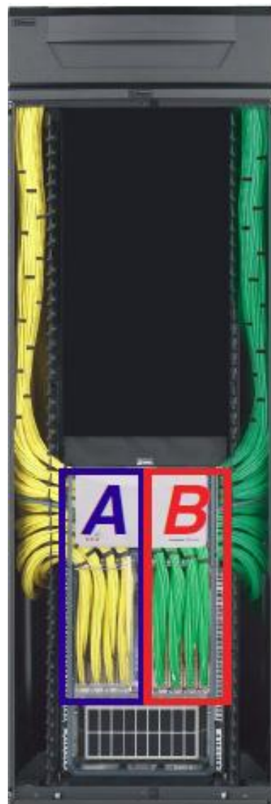
例 1: キャビネット 1 台当たりスイッチ 1 台： 同一キャビネット外に配線
